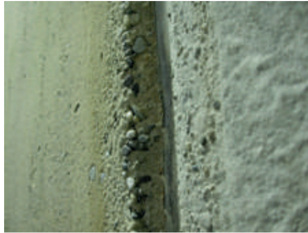
Corrosión del concreto en la zona de gas del tanque de sedimentación final de una PTAR debido al ambiente corrosivo del ácido sulfhídrico ( H_2S ). Foto Planta de tratamiento de aguas residuales Pro Rheno Basilea, Suiza.
